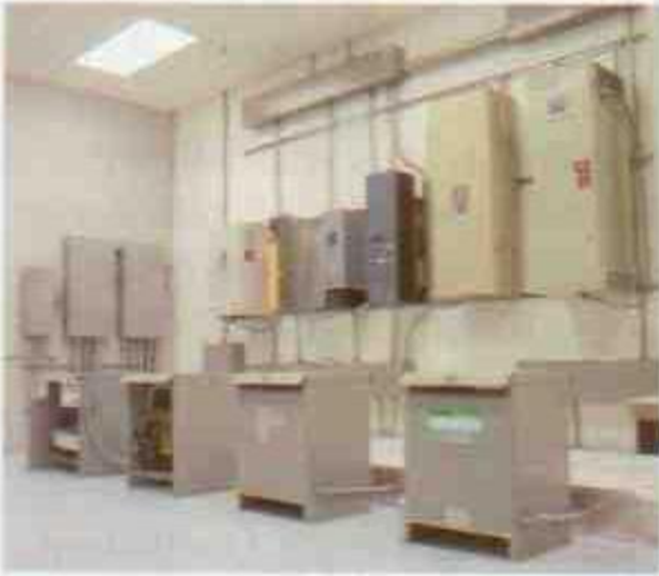
Şekil 4. MIRUS'daki VFD ile Test Alanından Bir Bölüm
